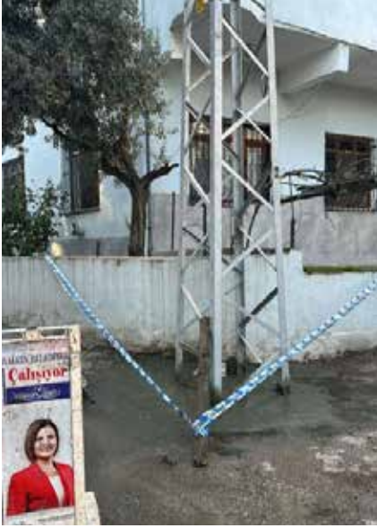
YENİŞEHİR MAHALLESİ KURTOĞLU SOKAK NO:7 SEDAŞ
